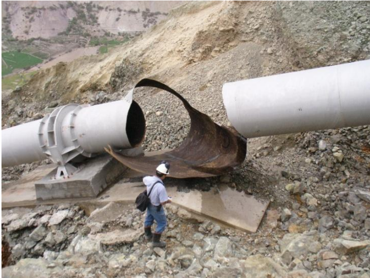
Bruch einer Druckrohrleitung, Argentinien
